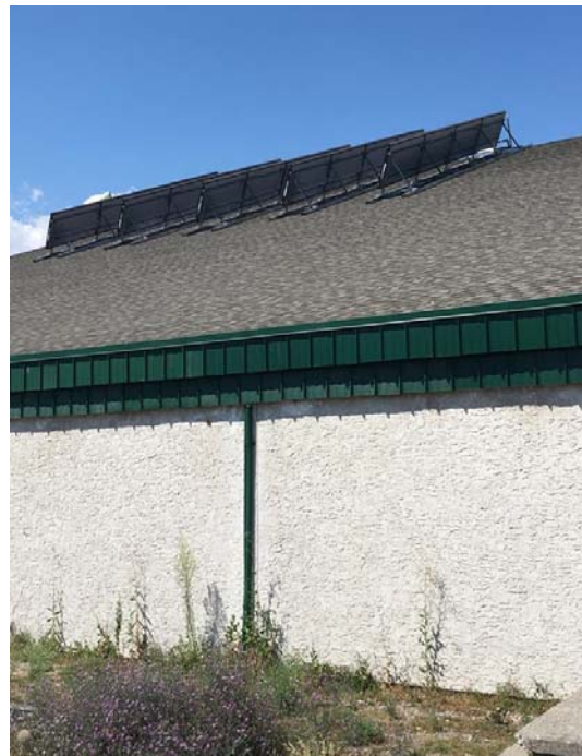
Photo E13 Solar Panels
