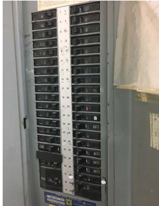
Photo E3 Panel B Breakers
