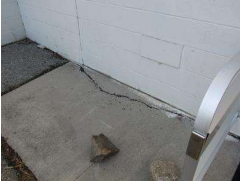
Photo #A3: Crack on Concrete apron.
